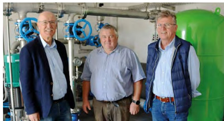
Im Innern des Pumpwerks läuft die Technik, von der sich (v.l.) Laabers Bürgermeister und 2. Vorsitzender des Wasserzweckverbandes Laaber-Naab Hans Schmid, der stellvertretende Werkleiter des Wasserzweckverbandes Laaber-Naab Manfred Achhammer und der Verbandsvorsitzende des Wasserzweckverbandes Hohenschambacher Gruppe Johann Heß, ein Bild machten. Bild und Text: Markus Bauer
